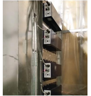
Hava Besleme kanalının çevresine monte edilmiş iyonlaştırıcılar.
